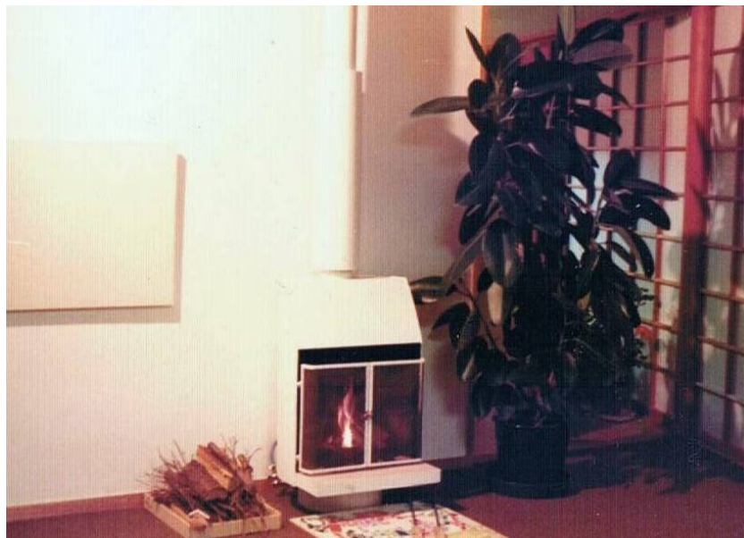
10帖ほどのリビングに特注のストーブを設置、このリビングには、温水床暖房が仕込まれています。*
